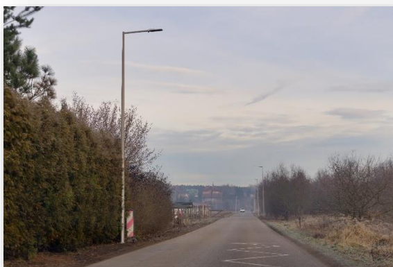
Zdjęcie nr 21. Oświetlenie ulicy Północnej w Kuczowie
